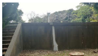
老朽化が進む配水池
