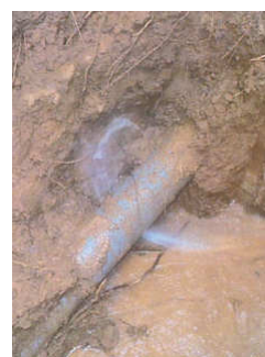
古くなった水道管の破損
