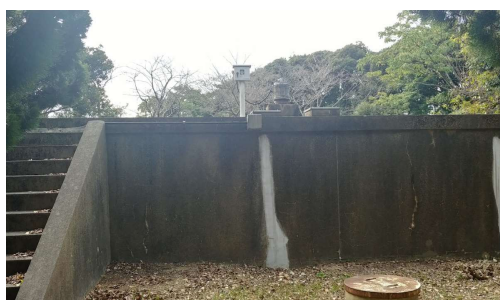
老朽化が進む配水池
