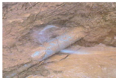
古くなった水道管の破損
