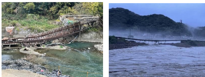
▲令和 5 年 (2023 年) の豪雨による被害状況
