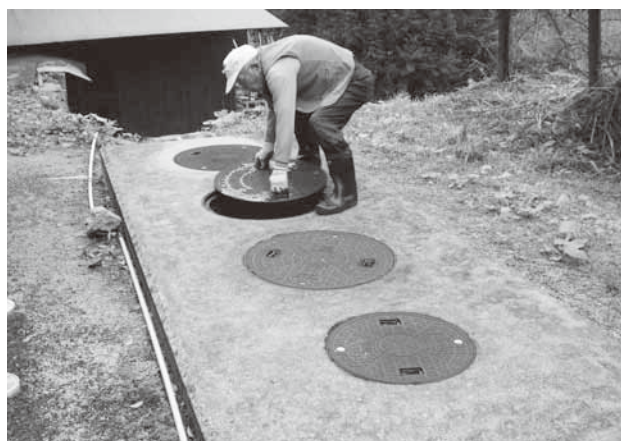
合併処理浄化槽
