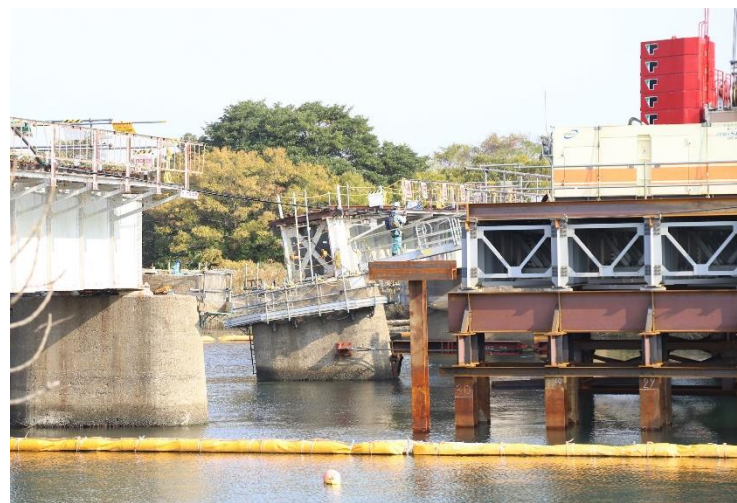
(12/3 傾斜した橋脚の状況)
