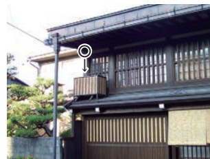
○木柵と簾で室外機を隠す工夫 (高山)
