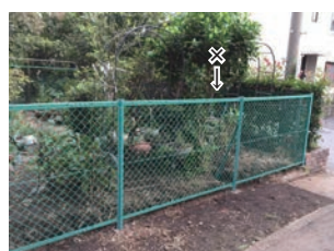
×金網フェンス
