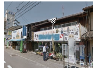
×劣化した建物を覆う新建材の看板
