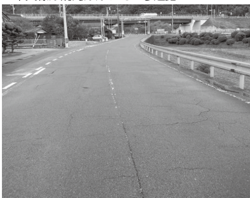
▼中央線が消えかかっている道路
