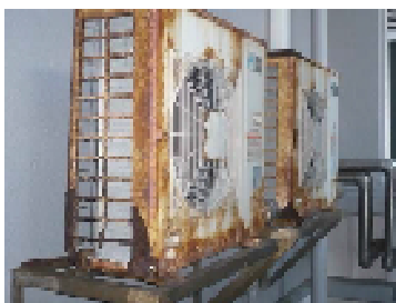
エアコン室外機の腐食
