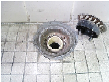
トイレ床排水口からの異臭
