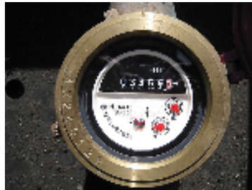
漏水の確認（水道メーター）
