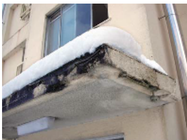
庇、軒裏の剥落
