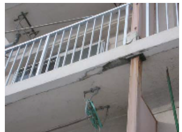
手すりのグラツキ
