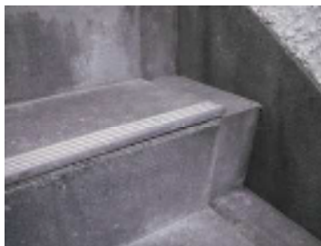
階段滑り止めの浮き、欠損
