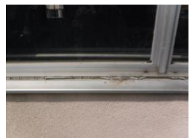
シーリング材の硬化
