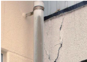
モルタルの落下
