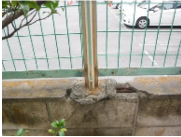
支柱部分の腐食
