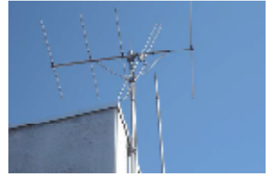
設備機器の落下の危険性
