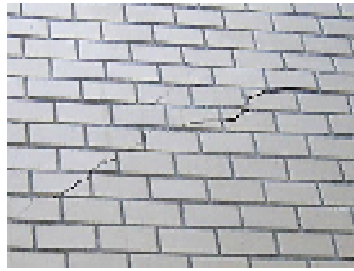
タイルのクラック
