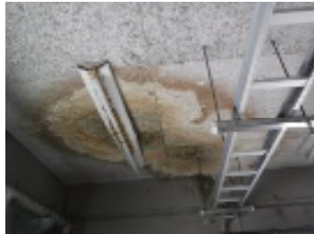
照明器具の腐食
