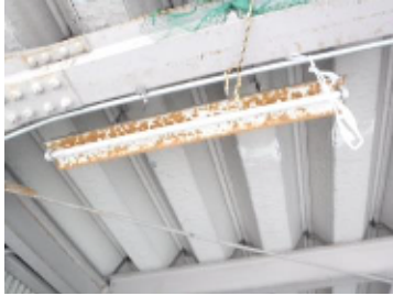
照明器具の損傷
