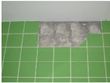
タイルの剥離
