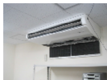
エアコン室内機フィルターのほこりのたまりの確認
