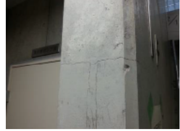
コンクリート柱のクラック
