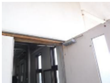
ドアクローザーの破損
