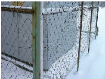
金属フェンスの破損
