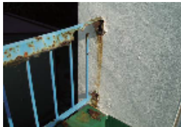
手すりの腐食
