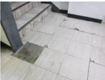
仕上げ材の剥離
