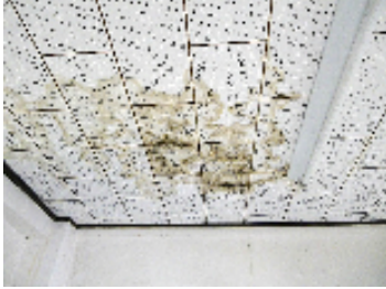
雨漏りによる天井面のシミ
