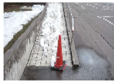
スロープの滑り
