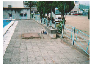
フェンスのクラツキ
