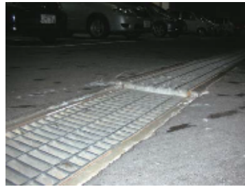
グレーチングの段差
