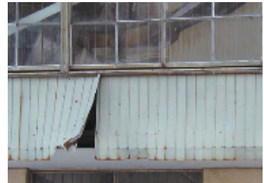
金属板の剥がれ
