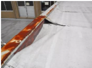
防水層の剥がれ
