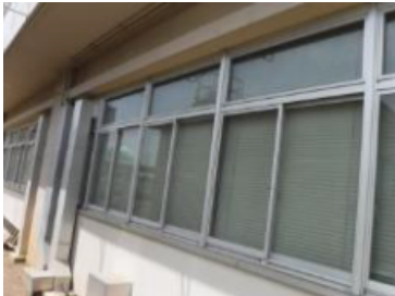
窓のガタツキ
