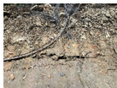
クラック 発生箇所
