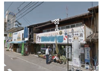
×劣化した建物を覆う新建材の看板
