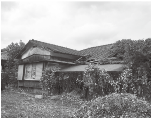
▼老朽化した空き家
