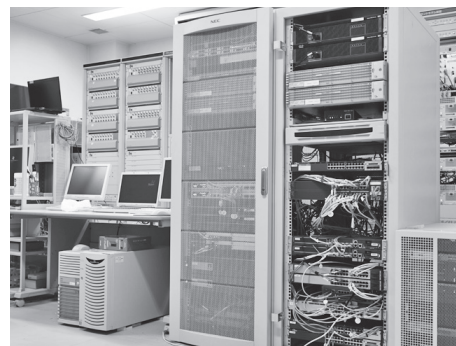
▲放送センター内の放送機器
