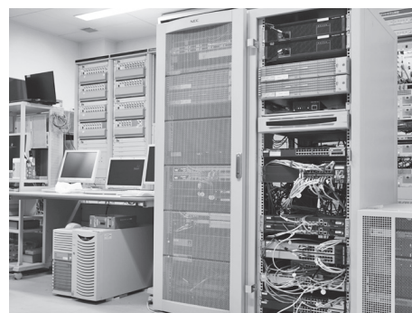
▲放送センター内の放送機器
