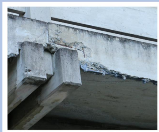
外壁コンクリートの落下跡
