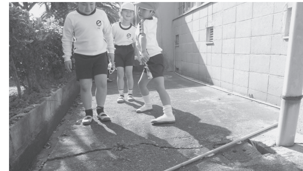
多くのひび割れのある油谷小学校
