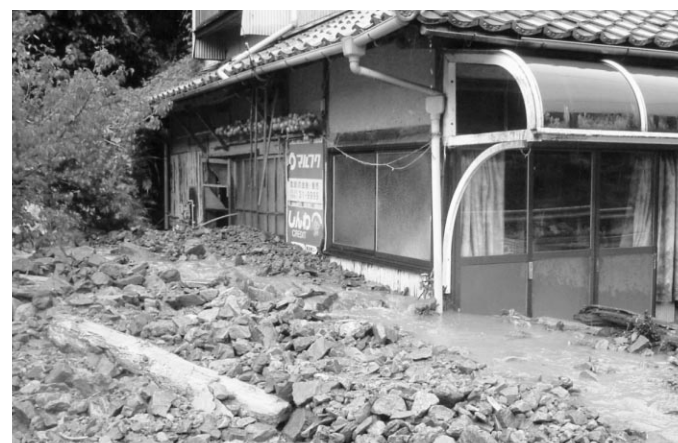
豪雨による土砂災害（三隅地区）
