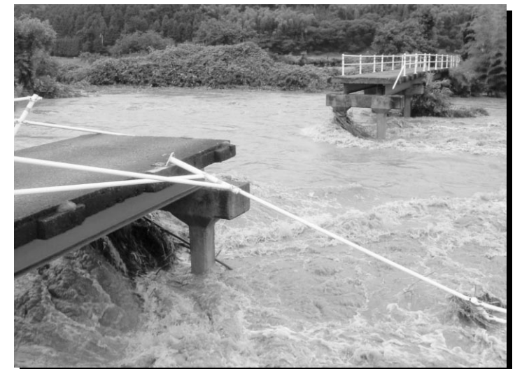
流出した成道橋(三隅地区)
