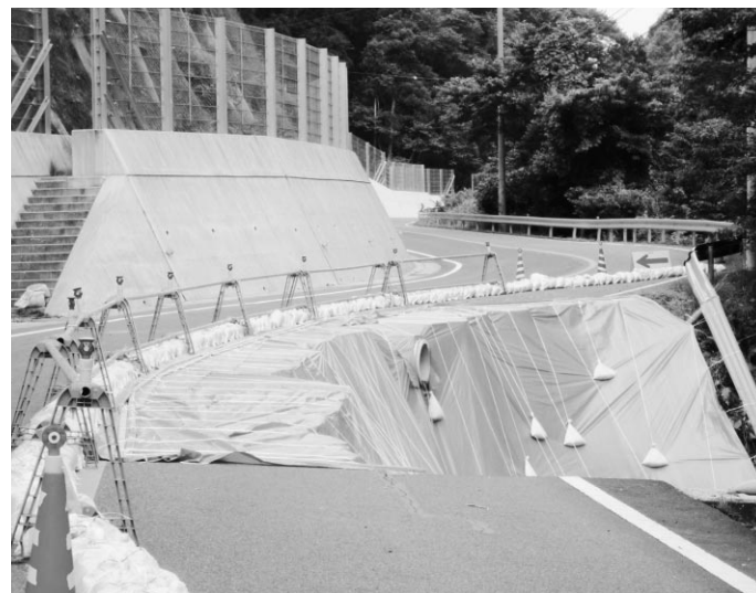
道路の崩落により通行止めとなった大寧寺峠
